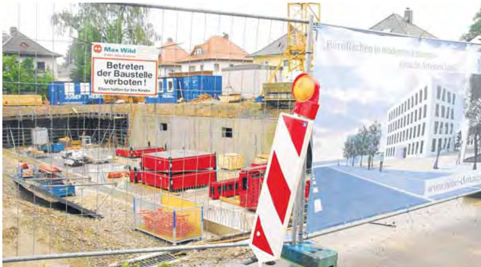
Der erste Spatenstich für den neuen Donaupark in Memmingen wurde gestern gefeiert. Zu dem Großprojekt an der Donaustraße gehört auch ein Bürogebäude, wie es auf dem Plakat am Bauzaun zu sehen ist. Foto: Simone Schupp
